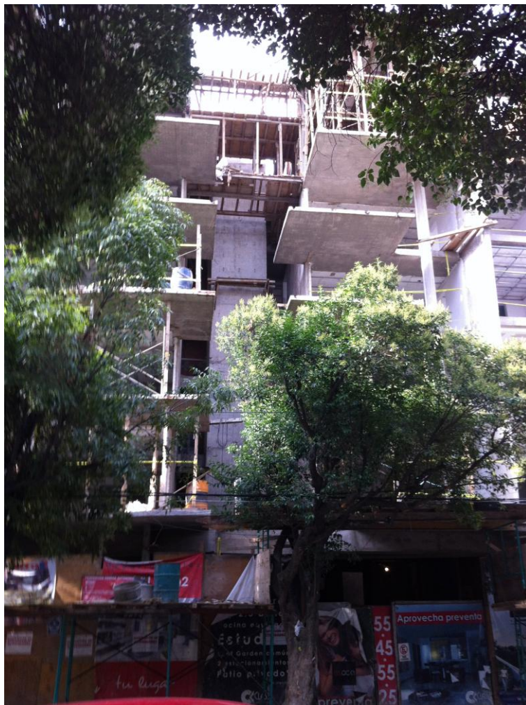
Edificio que sobrepasa los 3 niveles de altura permitidos y realizado sobre un predio catalogado por el INBA. Autor: Luis Salinas (junio de 2011).
